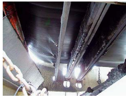
Fot. 5. Widok zamontowanego na przenośniku taśmowym systemu czyszczenia taśmy, jak na fot. 4, oraz natrysku wody
