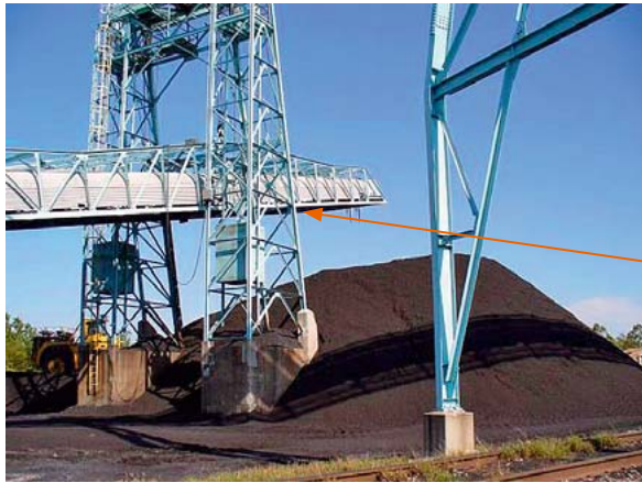
Fot. 3. Widok systemu zabezpieczającego przepelnienie składowiska produktu. Strzałką zaznaczono miejsce mocowania czujnika
