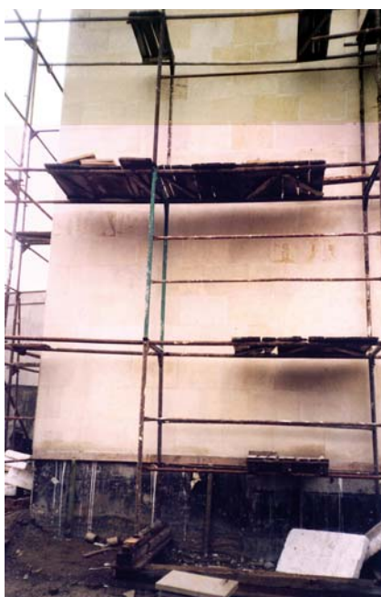
Przykłady nieprawidłowych konstrukcji rusztowań
