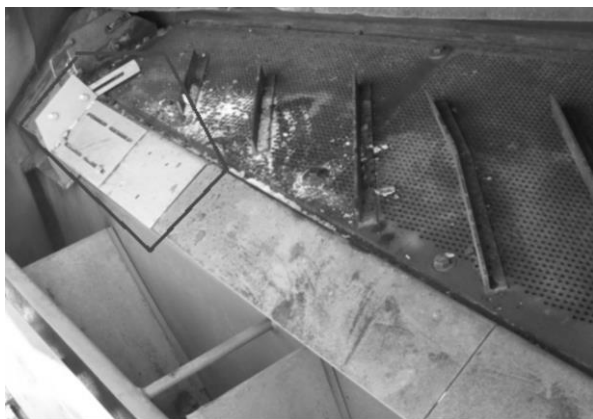
Zdj. 6a. Zmiana konstrukcyjna progu przesypowego do odbioru produktu odpadowego
